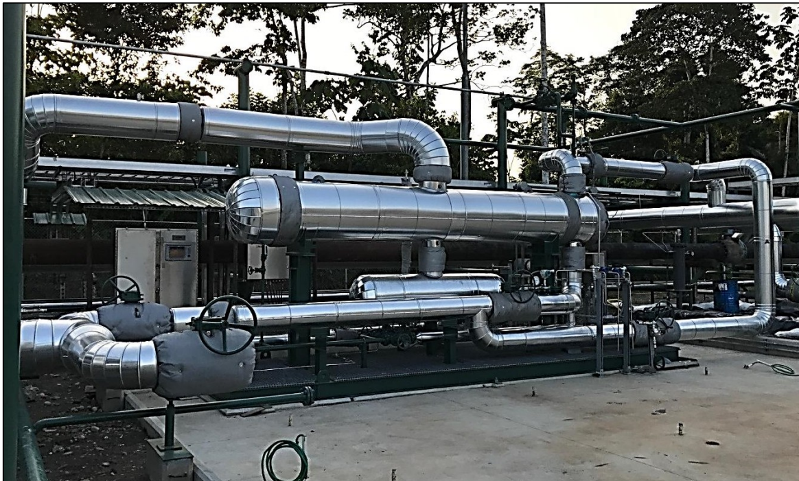
La fotografía muestra el intercambiador de calor instalado en la Central de Procesos Tiputini, fuera del Parque Nacional Yasuní.
