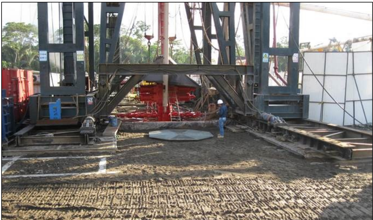
La fotografía muestra la construcción del cellar #23 para la perforación en la plataforma Tiputini C, fuera del Parque Nacional Yasuní.
