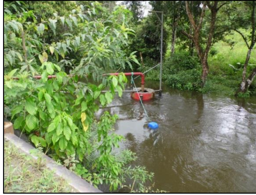
Fotografía N° 2: Captación de Agua Tipo, Petroamazonas EP
