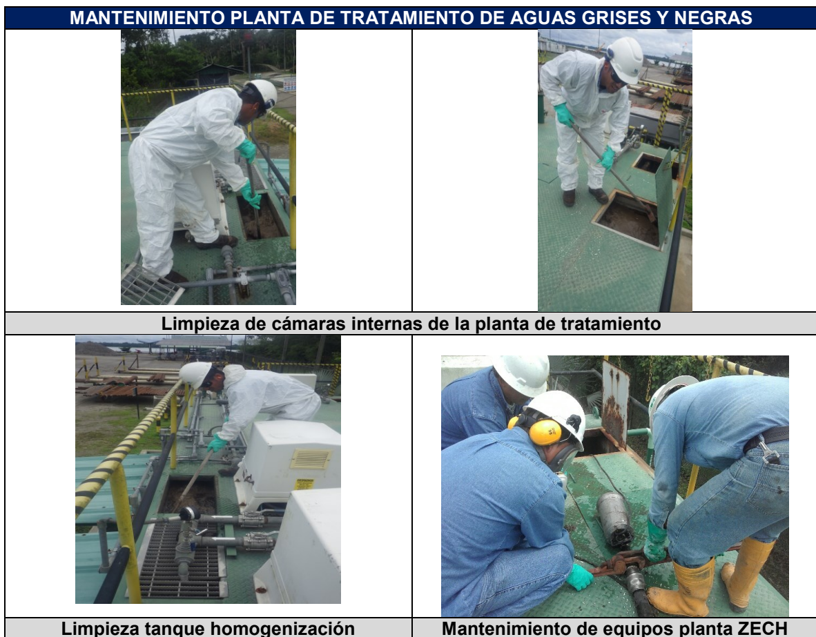
Fotografía N°1. MANTENIMIENTO PLANTAS DE TRATAMIENTO AGUAS GRISES Y NEGRAS
