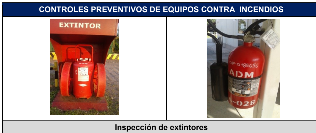
Fotografía N°9. INSPECCIÓN MENSUAL DE EXTINTORES
