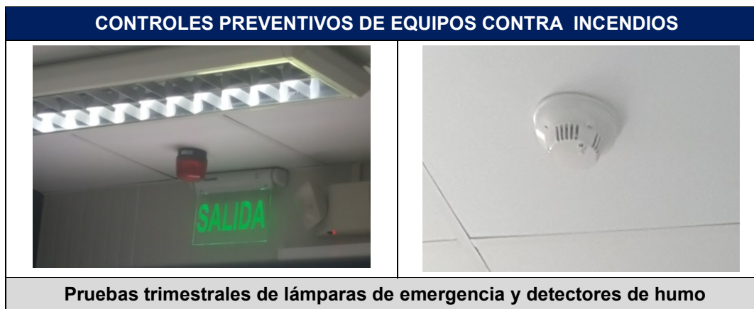
Fotografía N°8. CONTROLES PREVENTIVOS DE EQUIPOS CONTRA INCENDIOS
