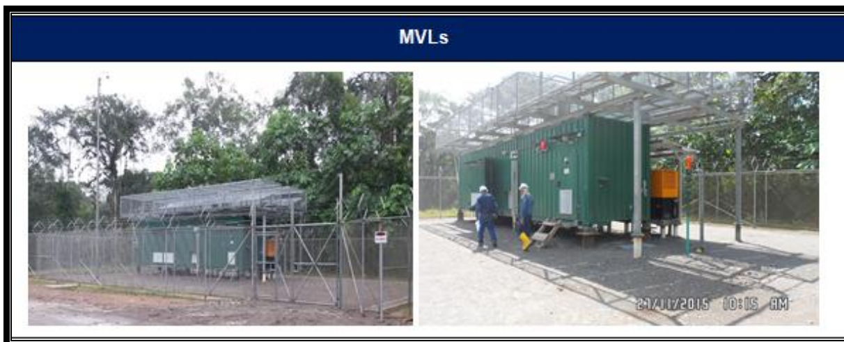
Fotografía N°6. PUESTA EN OPERACIÓN MLVs Y SISTEMA DE DETECCIÓN DE FUGAS
