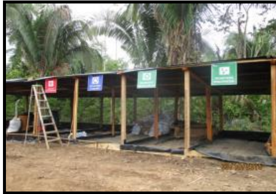
Fotografía N°19. Centro de acopio de desechos Plataforma Tiputini B
