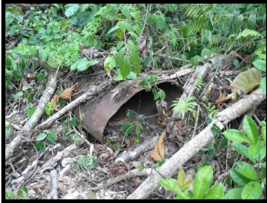
Fotografía 15: Pedazo de alcantarilla
