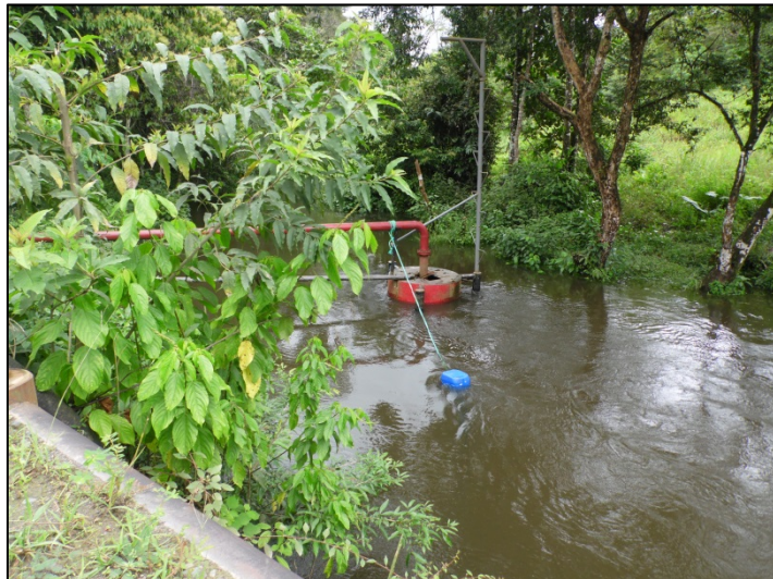
Fotografía N° 4.6.2.- Captación de Agua Tipo, Petroamazonas EP
