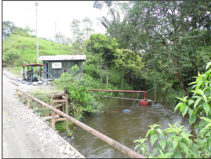
Fotografía N° 4.6.1.- Caseta de Captación de Agua Tipo, Petroamazonas EP
