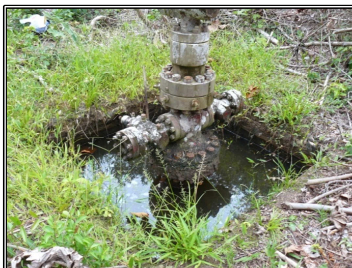
Fotografía N° 4.6.2.- Cabezal del pozo Tambococha
