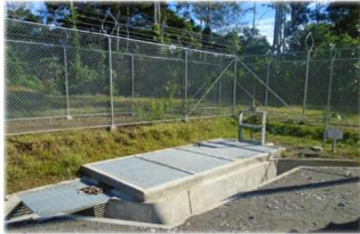
FIGURA N° 129.- SEPRADORES API - AGUAS PLUVIALES
