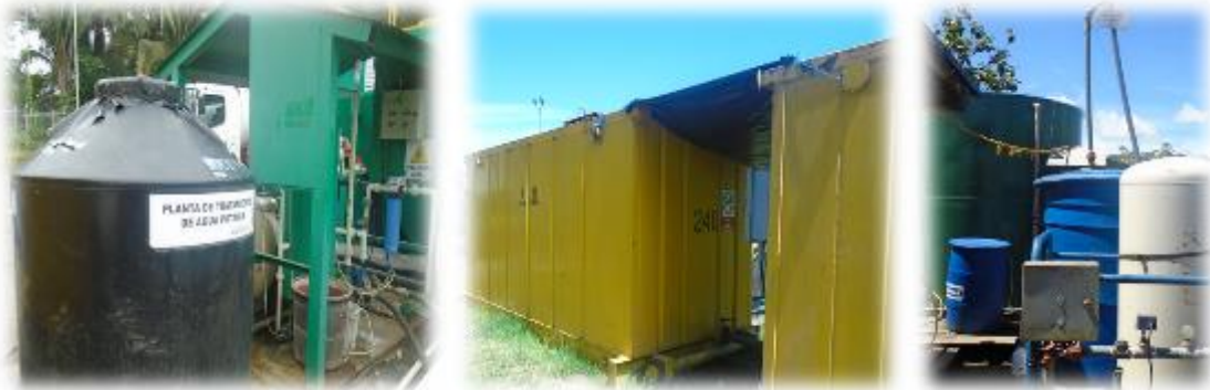
FIGURA N° 127.- TRATAMIENTO DE AGUAS
