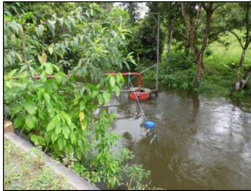
Fotografía N° 2: Captación de Agua Tipo, Petroamazonas EP
