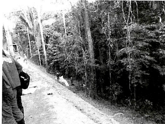
Trabajos en el acceso donde se prevé construir la Plataforma Tambococha B
