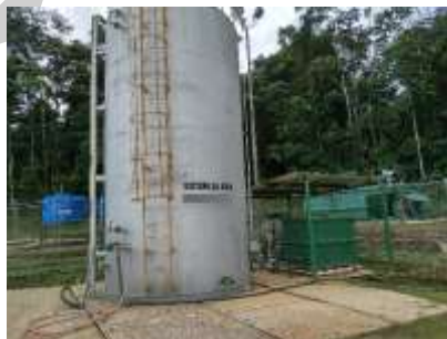
FIGURA N° 24.- EJEMPLO DE TRATAMIENTO DE AGUAS
