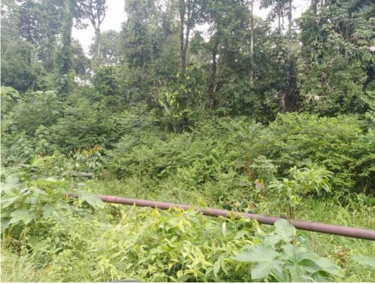
3Foto. Ducto para el transporte de crudo
